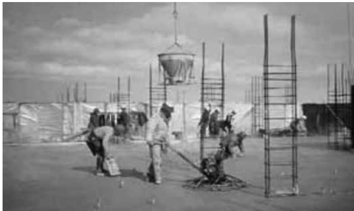
Figura 1: Las barreras corta-vientos pueden ser necesarias en clima frío porque la baja temperatura del aire, baja humedad relativa y alta velocidad del viento pueden llevar a un agrietamiento por retracción plástica. (Foto cortesía de Portland Cement Association)
